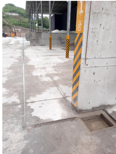
碎玻璃仓沥水收集沟及收集池
