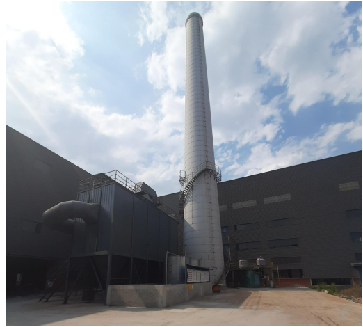
脱硝处理设备及排气筒
