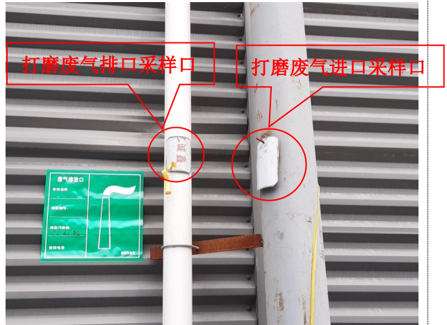
打磨废气采样口
